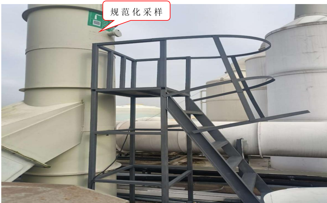
废气规范化采样口
