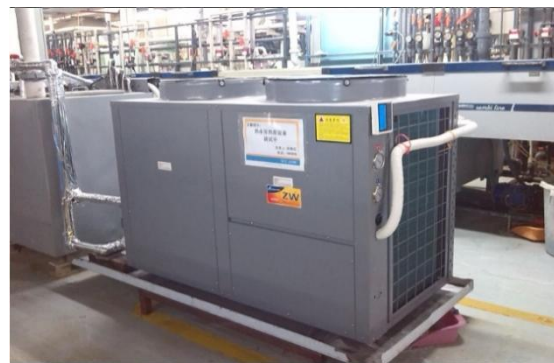
空气能热泵现场图片
